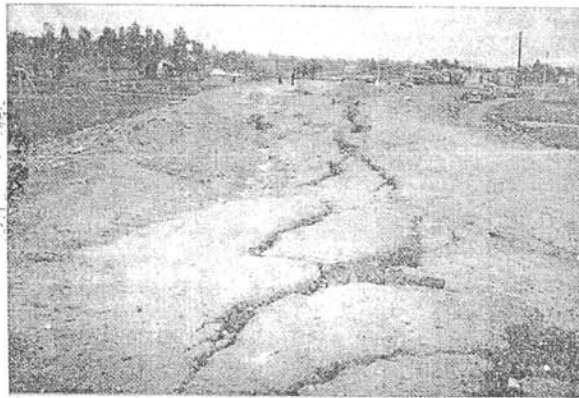
c) Trượt sâu trên đường dẫn vào cầu Hoàng Long Hình 4.2: Trượt sâu xảy ra theo mặt cắt dọc của đường trong quá trình thi công.
