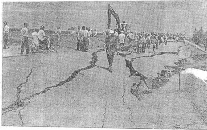
b) Phá hoại do trượt sâu ở đường vào cầu Trìa trên QL 1A tỉnh Quảng Trị (7 - 2001)
