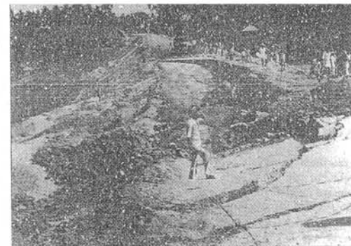
a) Trượt sâu của mặt nền đường đắp
